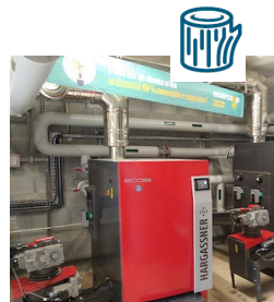
Réseau de chaleur Lucinges « Biomasse » 1,1 GWh/an
