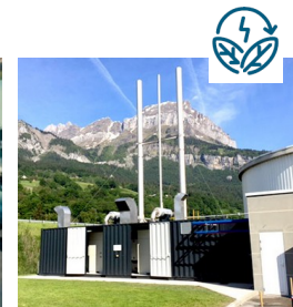
Méthanisation STEP Sallanches Cogénération 1,7 GWh/an
